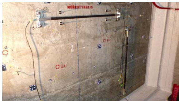
Obr. 6: Fotografie instalovaných senzorů
